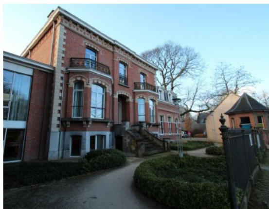
Het leien dak van het Zwaluwneest vertoont lekken. FOTO'S FISP
